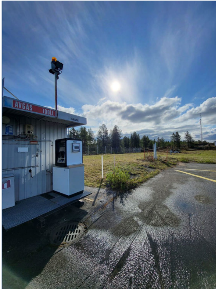
Kuva 3. Jakelupisteen takana pohjavesiputki PVP2015 (valkoinen putki). Kauempana öljynerotuskaivo (siniset putket).
