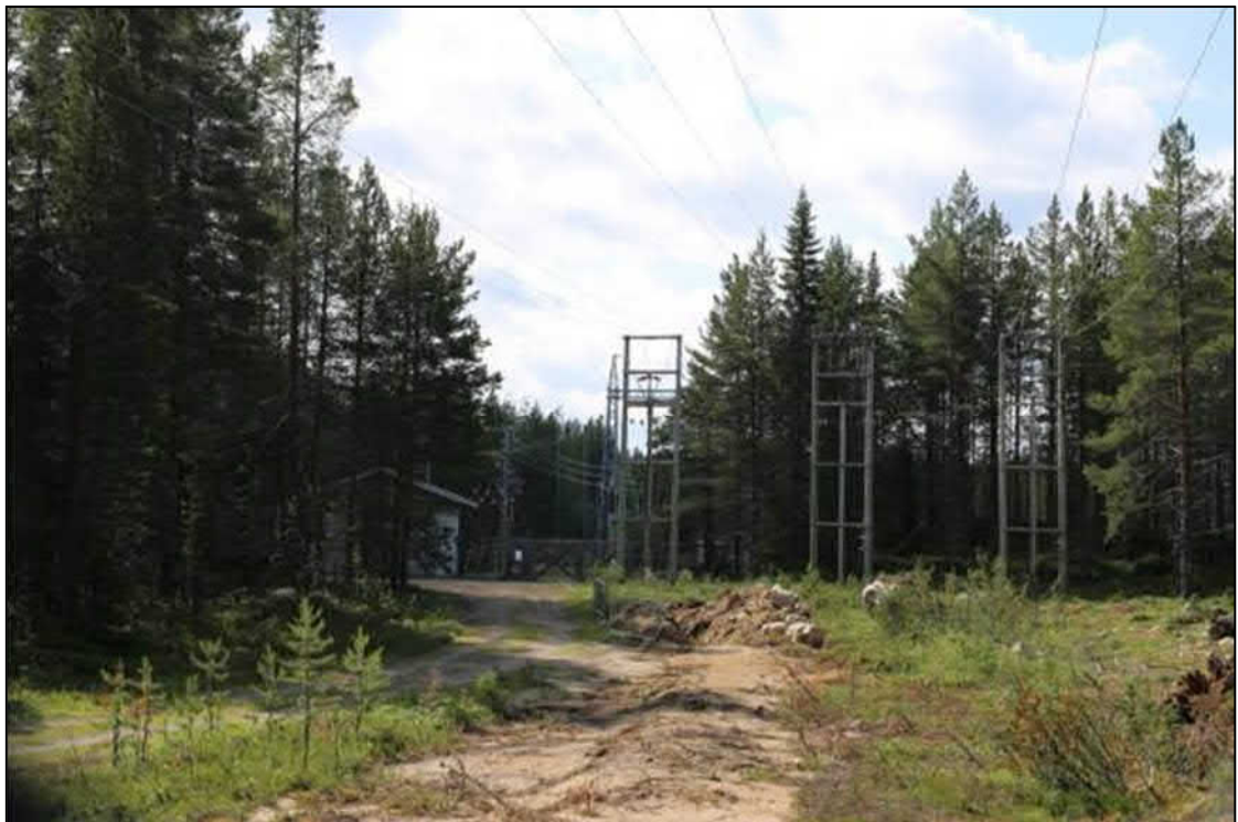
Kuva 52. Viipusjärven sähköasema sijaitsee aivan Kemijärventien varrella. Sähkönsiirron VE Ruka voimajohto liitettäisiin tällä sähköasemalla muuhun sähköverkkoon.
